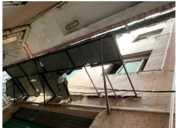
图 4.4.2-7 金属遮阳棚破损
