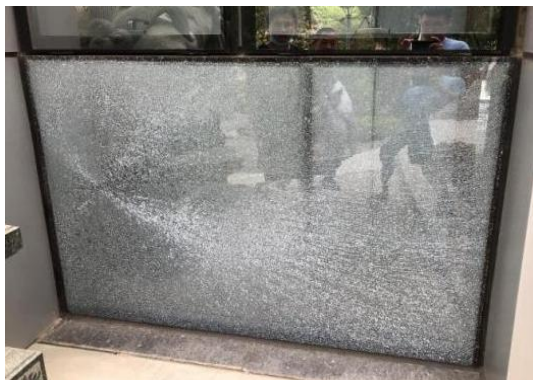
图 4.3.2-4 玻璃面板破碎
