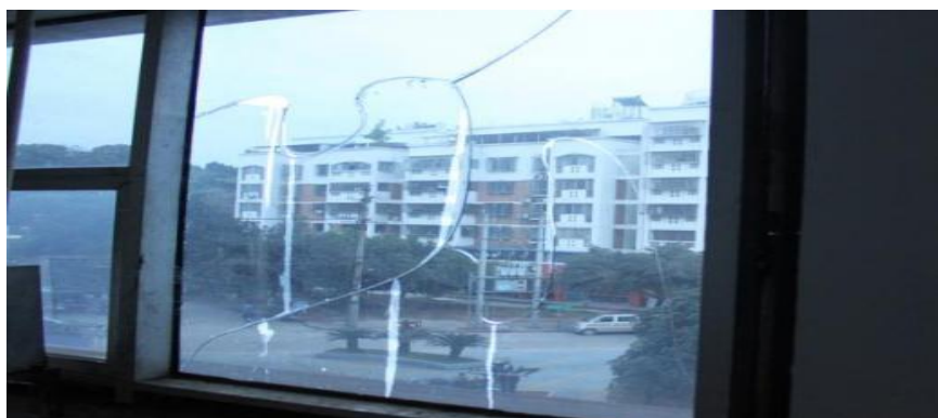
图 4.3.2-6 非安全玻璃破裂
