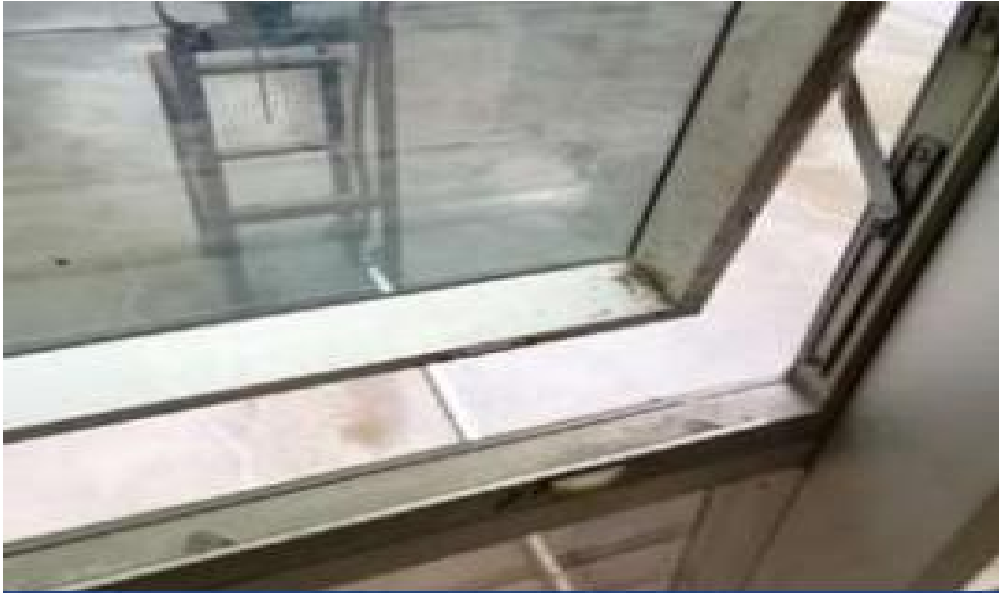
图 4.3.2-14 开启窗不能有效锁闭
