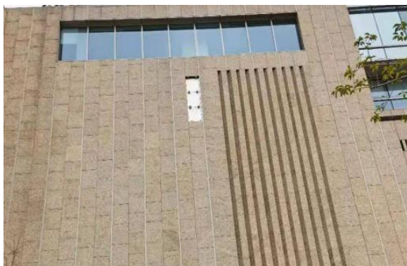
图 4.3.2-2 石材面板脱落
