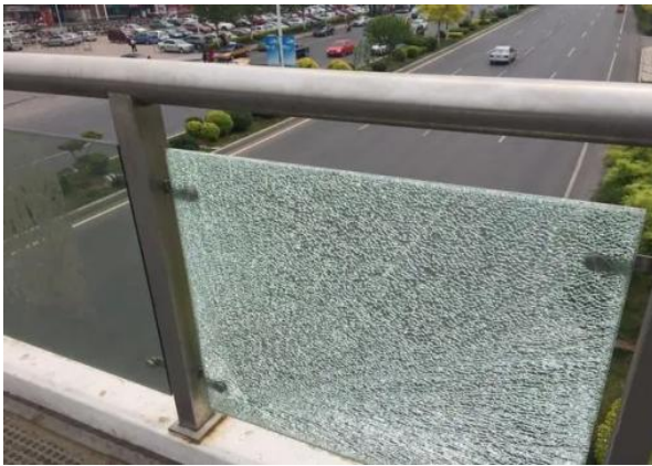
图 4.4.2-1 玻璃面板破损
