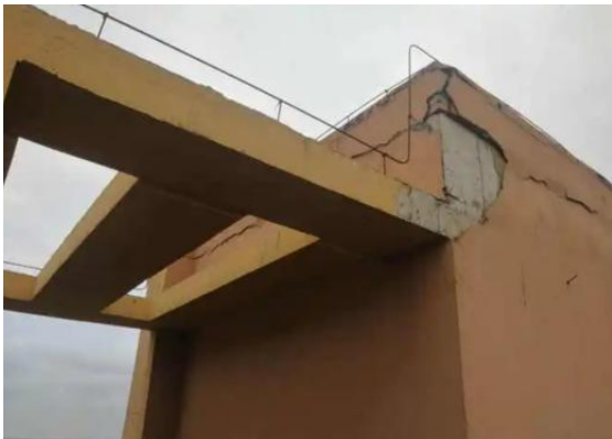
图 4.2.2-11 女儿墙开裂脱落
