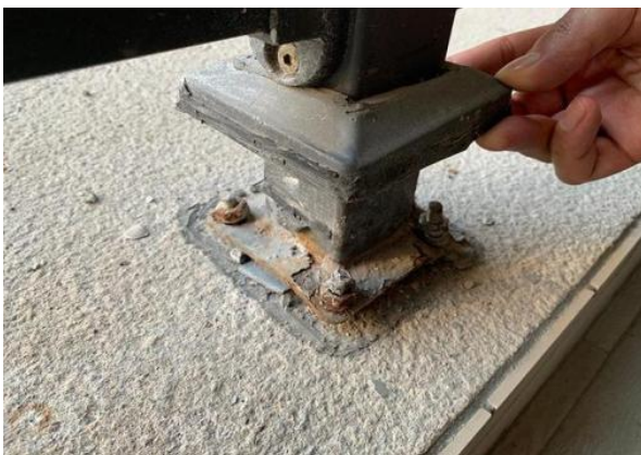
图 4.4.2-3 固定螺栓锈蚀
