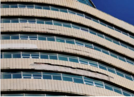
图 4.2.2-9 外墙饰面砖脱落
