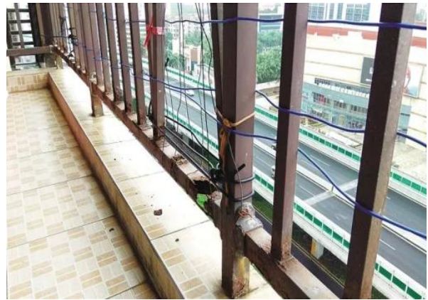
图 4.4.2-2 金属焊接处锈蚀破损
