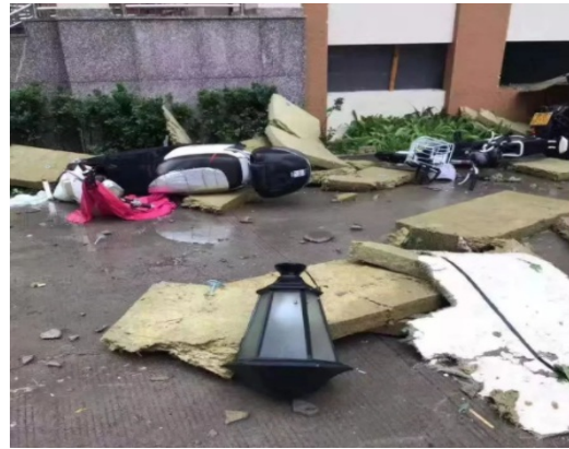
图 4.2.2-22 岩棉保温板脱落
