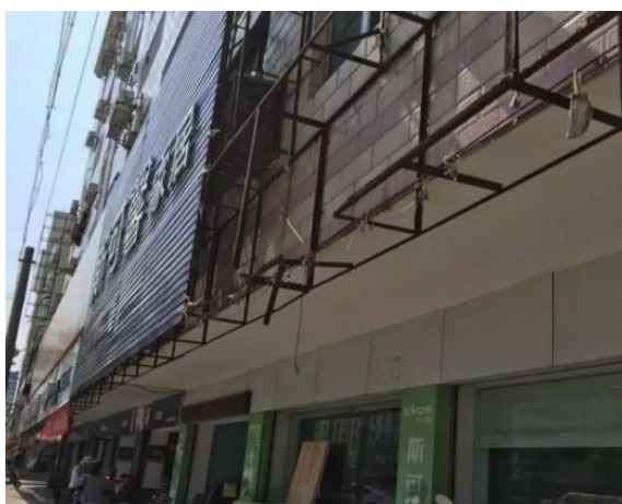
图 4.4.2-15 广告牌框架锈蚀
