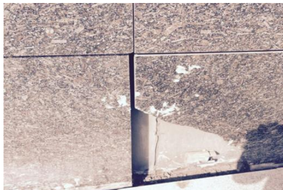
图 4.3.2-5 石材面板破裂
