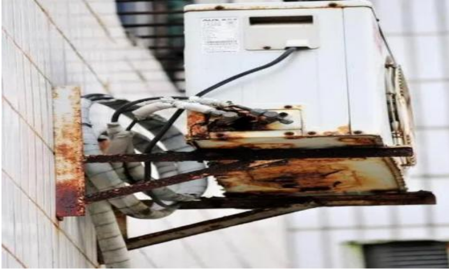
图 4.4.2-5 空调外机支架锈蚀
