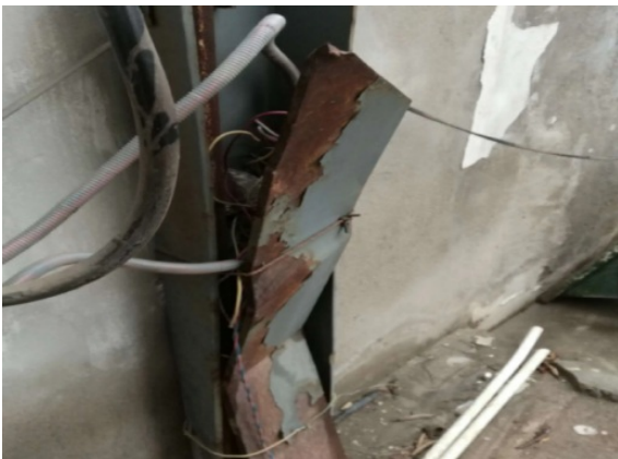
图 4.4.2-23 线槽破损锈蚀
