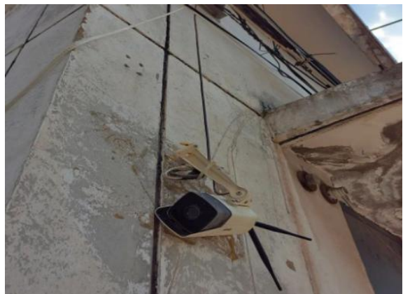
图 4.4.2-19 监控设备脱落
