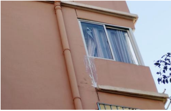
图 4.2.2-13 阳台根部开裂
