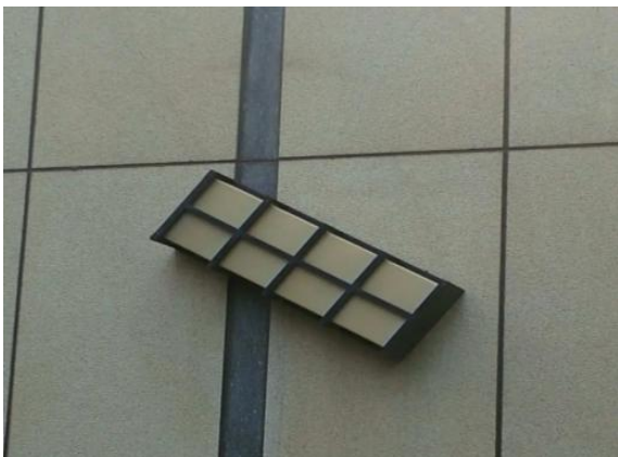
图 4.4.2-18 照明亮化设施脱落
