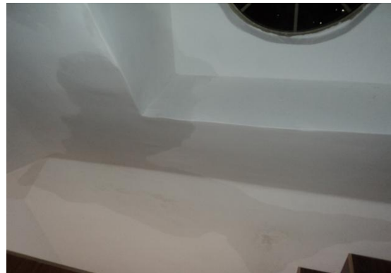
图 4.2.2-16 外墙阴阳角渗水发霉
