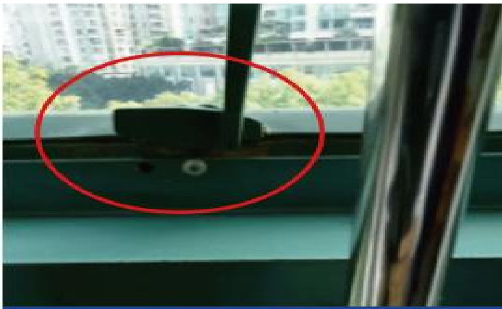
图 4.3.2-15 开启窗启闭受阻
