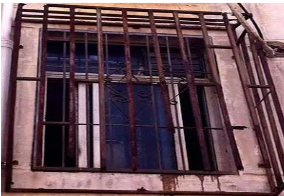
图 4.4.2-14 防盗窗整体锈蚀
