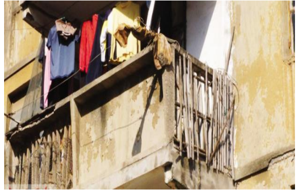
图 4.2.2-14 阳台护栏损坏
