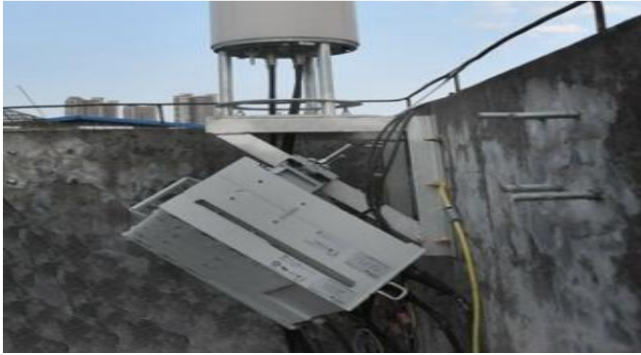
图 4.4.2-20 通信设备脱落
