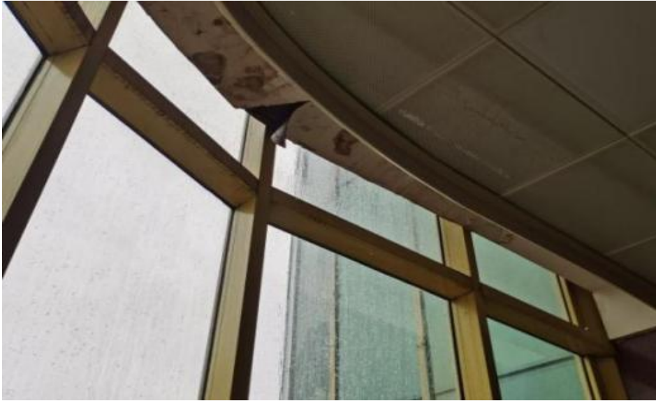
图 4.3.2-16 幕墙室内侧渗漏
