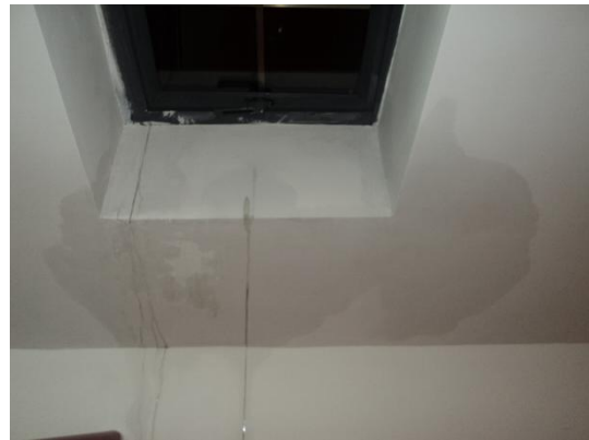
图 4.2.2-12 门窗洞口裂缝渗水
