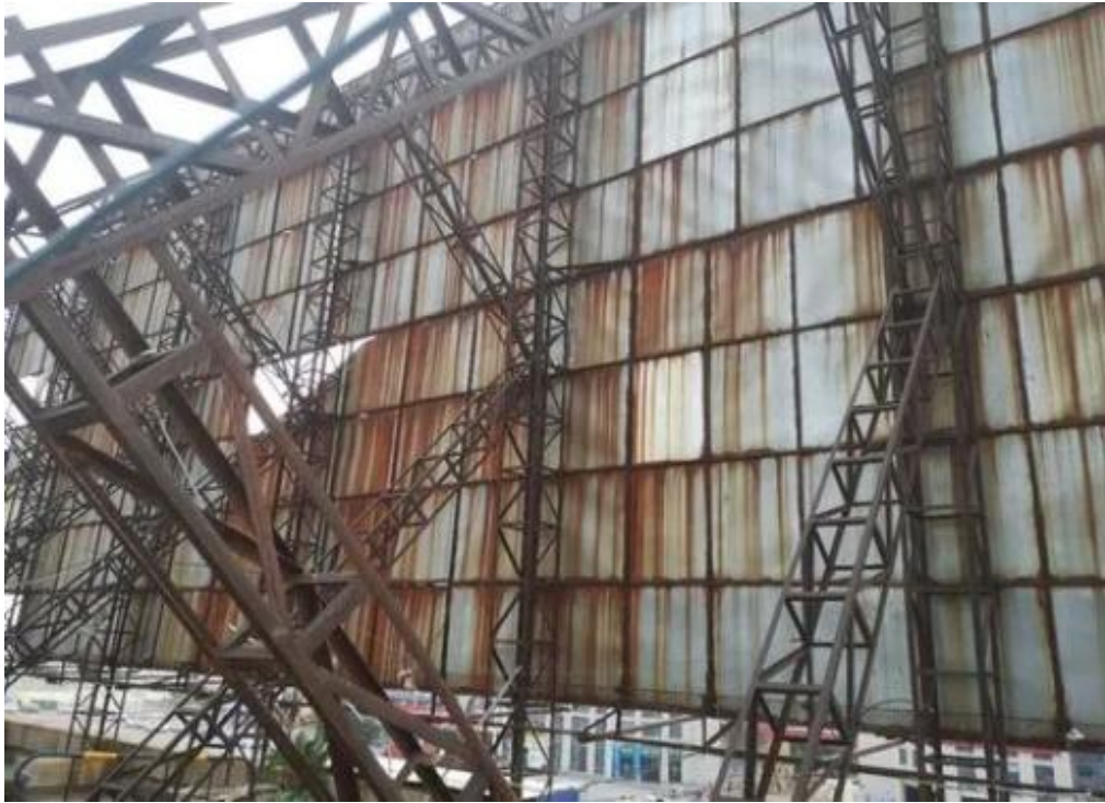
图 4.4.2-17 广告牌支撑结构锈蚀
