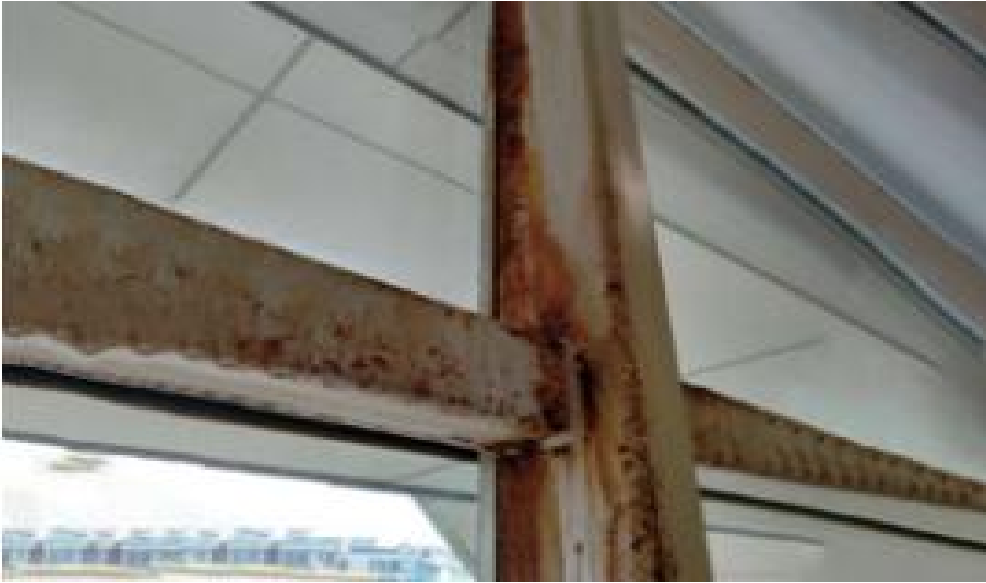
图 4.3.2-7 构件严重锈蚀
