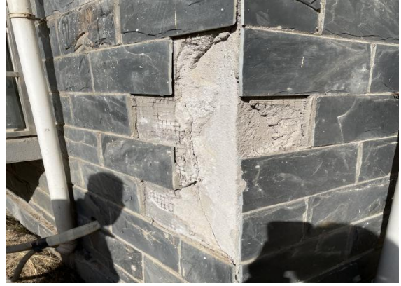
图 4.2.2-10 外墙饰面板脱落
